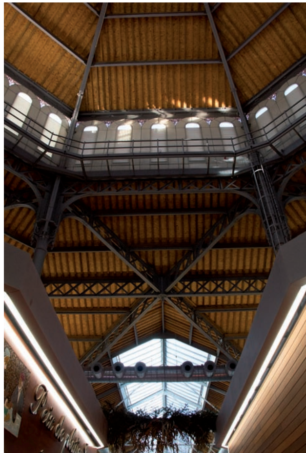
Vista en detalle de la instalación de climatización de la cúpula central del mercado de Sant Antoni
