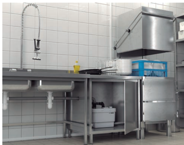
Sanispeed en cocina industrial
