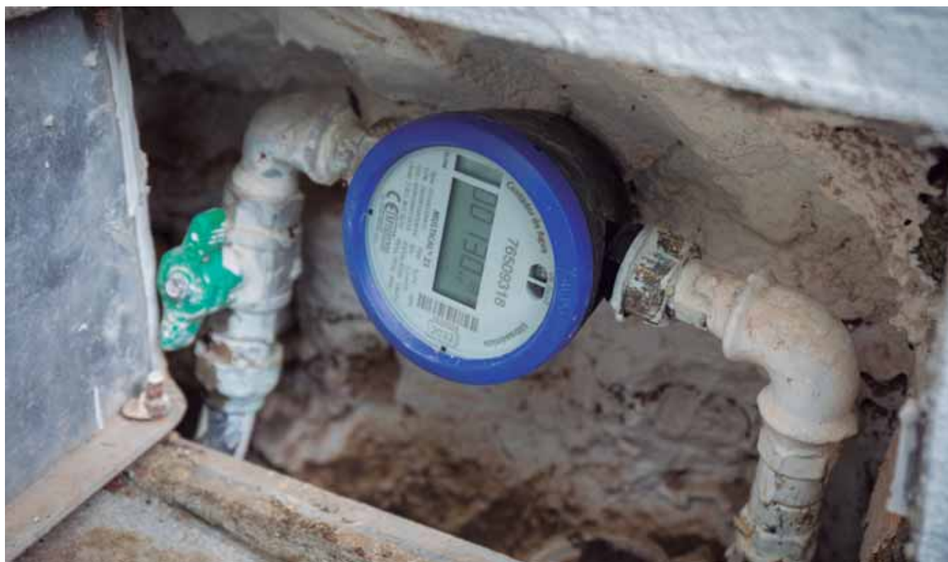
El sistema de lectura READy, desarrollado por Kamstrup, facilita la tarea de lectura de los contadores inteligentes
