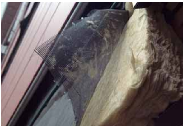
Una parte importante de las ayudas se centran en el aislamiento y la envolvente térmica
