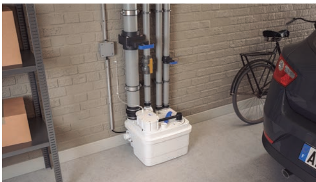
Estación bombeo SANICUBIC 1 en entorno
